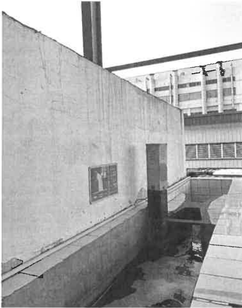
生产废水排放口
