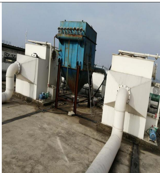
布袋除尘器和水膜除尘器
