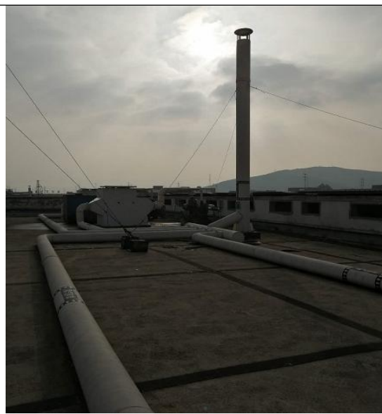
粉剂车间排气筒
