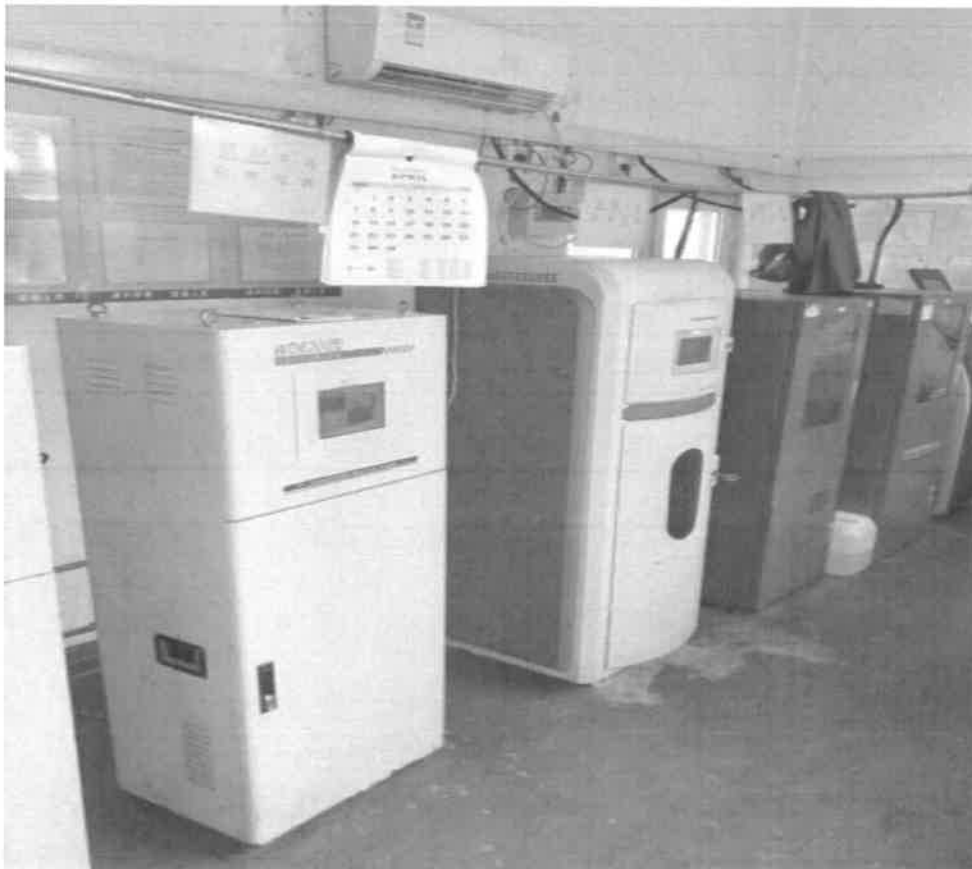
图 3-1 废水站在线监控设备
